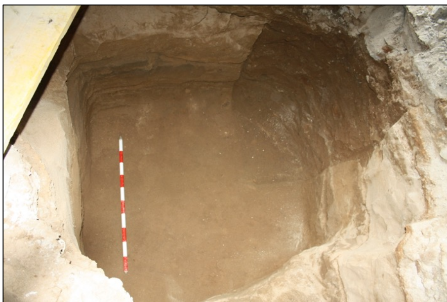
Fotografia 77. Pou sanejament per connectar amb xarxa del carrer.
