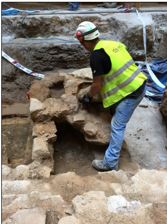
Fotografia 117. Desmuntatge estructures d'època medieval afectades per la grua.
